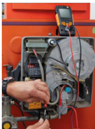
Pomiar prądu jonizacji na palniku kotła.
