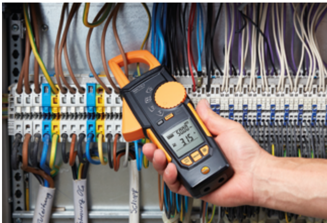
Pomiar prądu w szafach sterowniczych.
