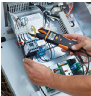
Pomiar napięcia na sprzężarce.
