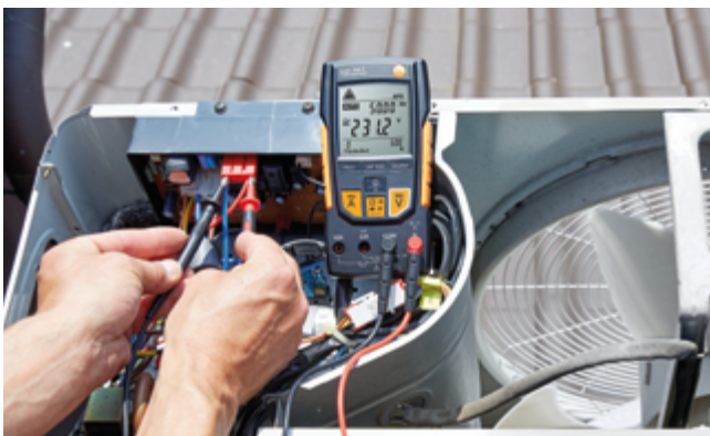
Pomiar napięcia na zewnętrznym urządzeniu chłodniczym z testo 760 .
