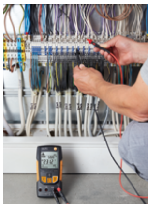
Kontrola napięcia w szafie sterowniczej.
