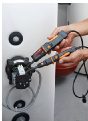
Pomiar napięcia na kotle.
