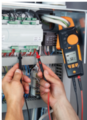
Pomiar napięcia w skrzynce elektrycznej w pompie ciepła, z możliwością zawieszenia przyrządu pomiarowego.
