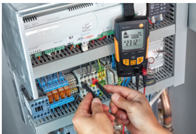
Kontrola napięcia w skrzynce elektrycznej pompy ciepła.
