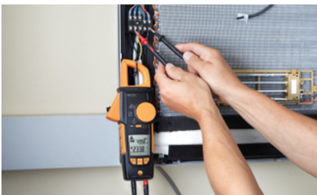
Pomiar napięcia na klimatyzatorze za pomocą testo 770 .
