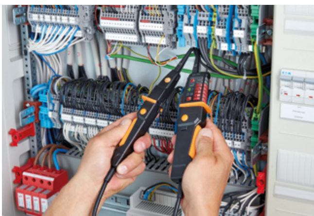
Pomiar napięcia w szafach sterowniczych.
