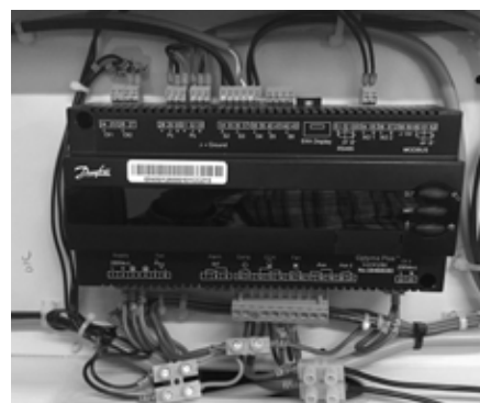
Bilde 4: Midlertidig kabling
