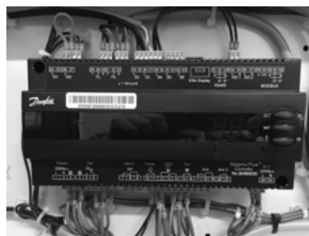
Bilde 3: Normal kabling
